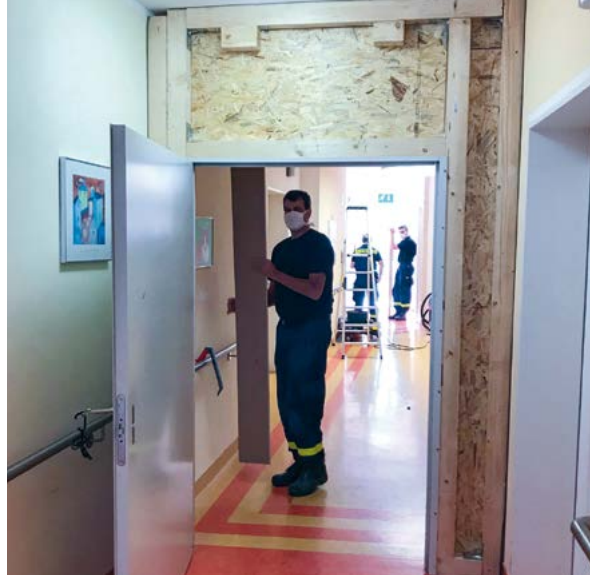
Bau der Isolierstation im Haus Maria Linden durch Mitglieder der Jugendgruppe des Technischen Hilfswerks Markt Schwaben.
